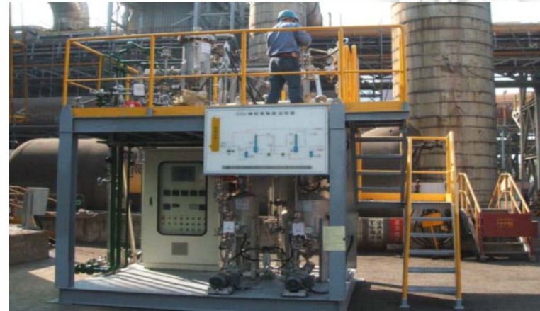
中鋼CO 2 捕獲工廠現場照片
